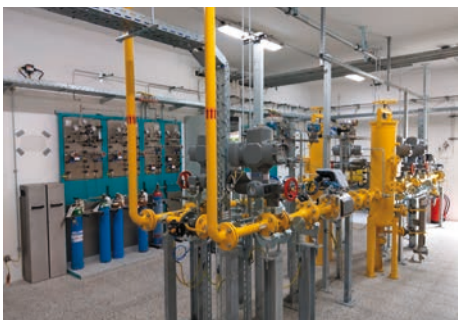
Biogaseinspeiseanlage Dresden Klotzsche; Auftraggeber: SachsenNetzeHS.HD
