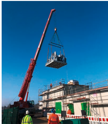
Auf Grundrahmen gepackter Hauptverdichter STREICHER; Auftraggeber: Stadtwerke Schwedt
