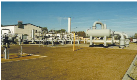
GDRA und Messstation Lauchhammer VNG
